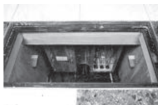
アトリウム床電源端子箱
