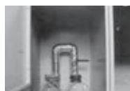
西3・4給排水Box
