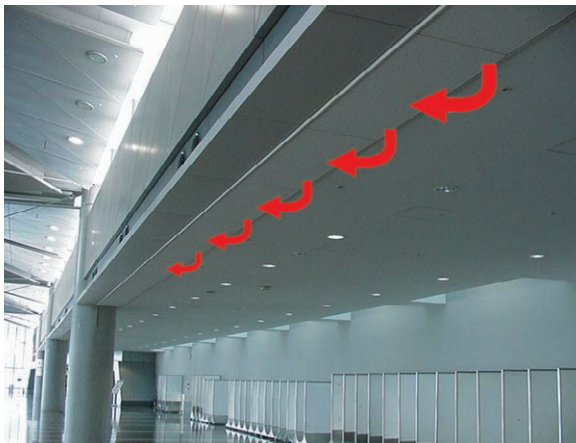
▲防煙垂れ壁平常時
